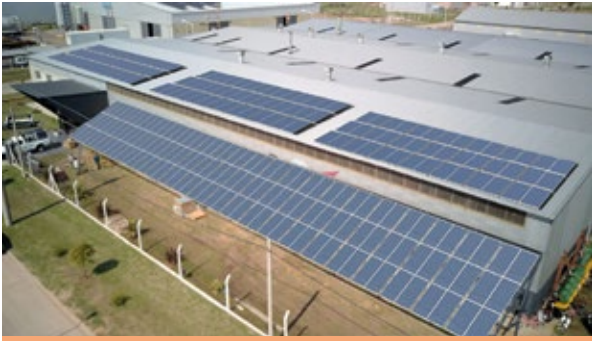
Parking Solar instalado en Rossmet SRL Fuente: LCE Sidereal
