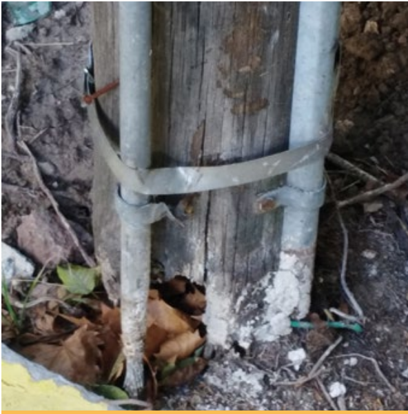
Puestas a tierra en un poste podrido en la base
