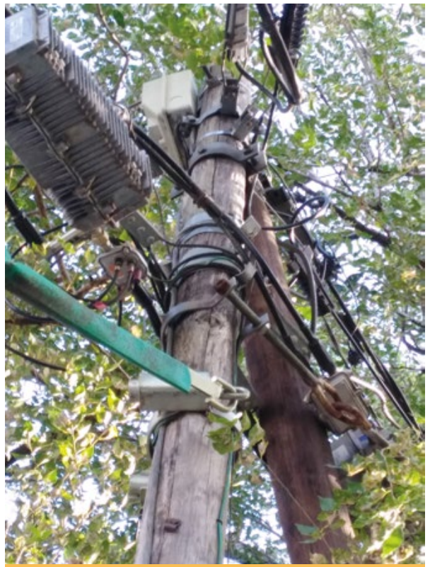
Poste de red eléctrica invadido por dispositivos de CATV
