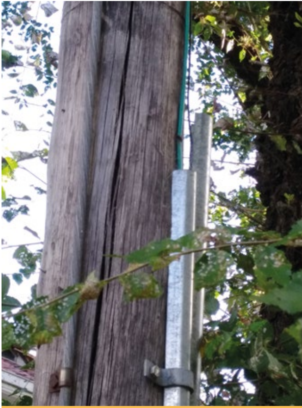
Poste de puesta a tierra de red invadido por bajadas extrañas
