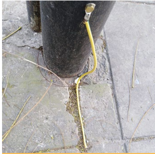
Puesta a tierra muy expuesta en una columna de alumbrado público
