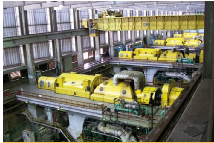
Central térmica clásica: una salida intempestiva de servicio evacuará automáticamente el calor acumulado
