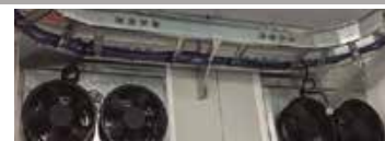
Refrigeración de tableros y salas eléctricas
