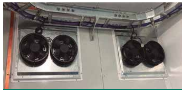
Shelters con forzadores extractores en sala de baterías
