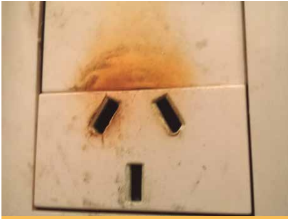
Figura 2. "Toma" reglamentario recalentado por sobrecarga y/o falso contacto, frecuentemente producido por insuficiente introducción de la ficha.
