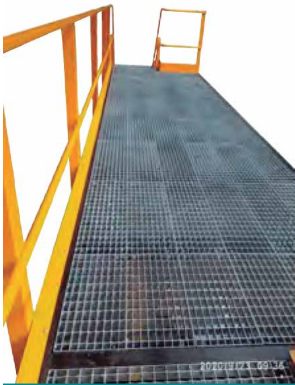
Figura 2. Emparrillado de piso y escalones con tratamiento de galvanizado en caliente
