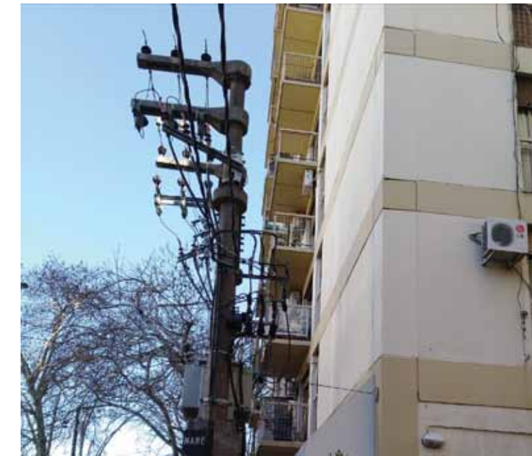
Foto 1. Contagio de instalaciones rurales a zonas urbanas: transformador aéreo alimentando la red subterránea.
