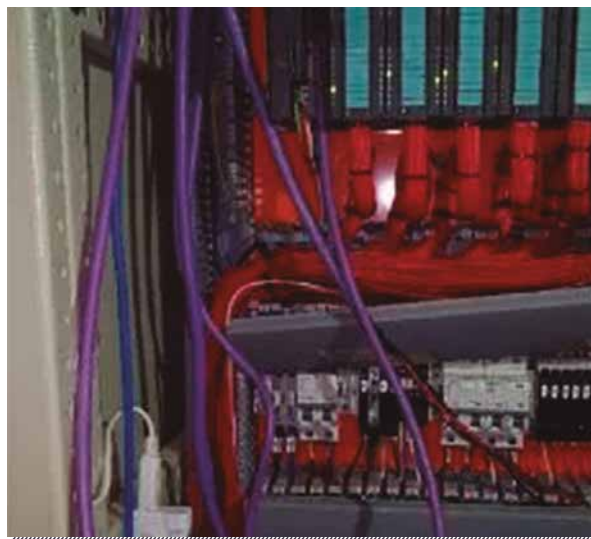
Figura 4. Cableado en desuso
