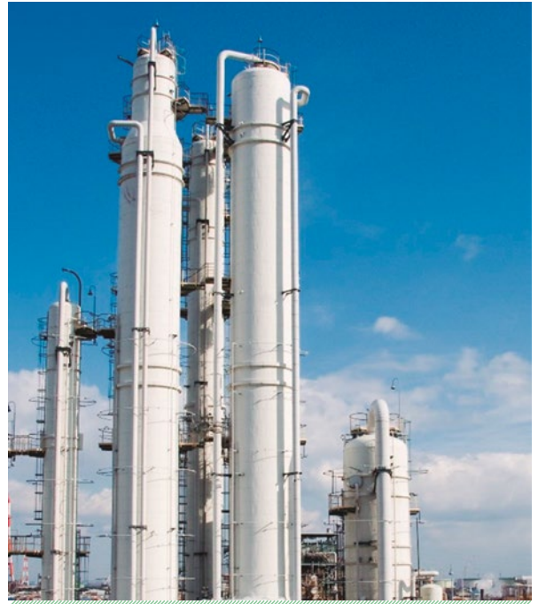
Columnas de destilación de la planta química de ENEOS Materials
