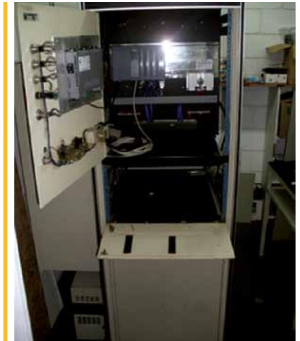
Figura 13. PLC y HMI instalados en la consola original del banco de ensayos
